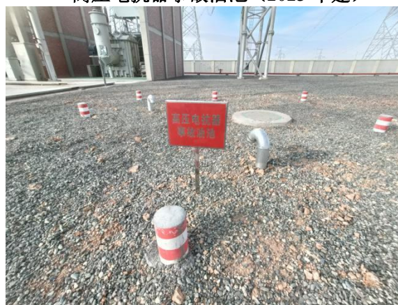
高压电抗器事故油池（2023 年建）
