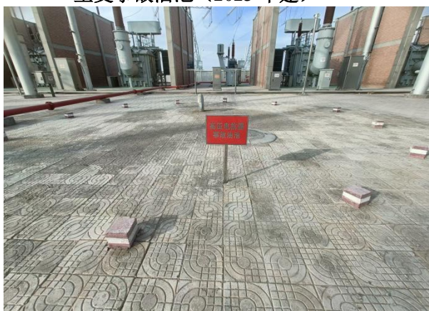
高压电抗器事故油池（2012 年建）
