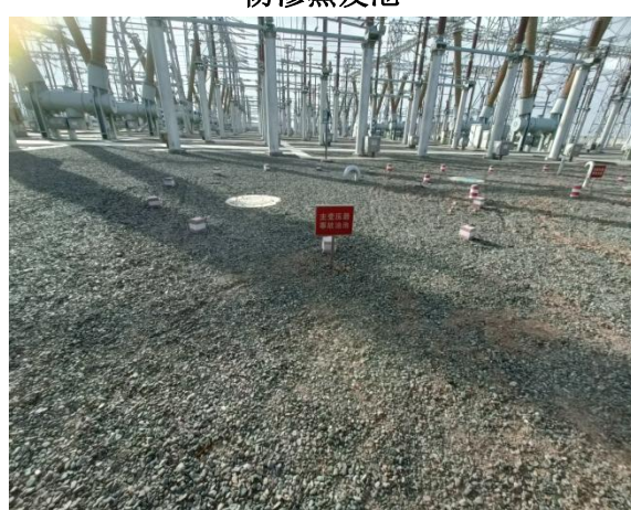
高压电抗器事故油池（2023 年建）
