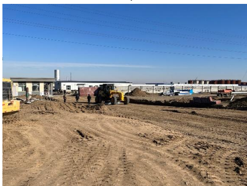
项目南侧昆仑天泽 LNG 项目厂区
