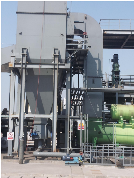
图 6.2-2 高温太棉除尘器
