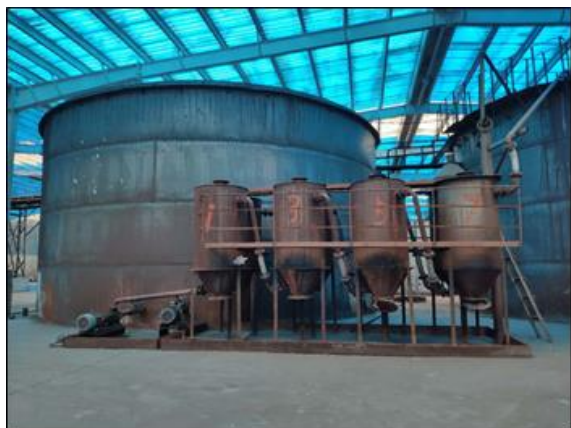
浸泡提金液吸附罐区
