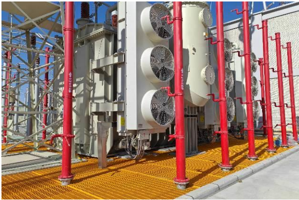
主变压器油坑
