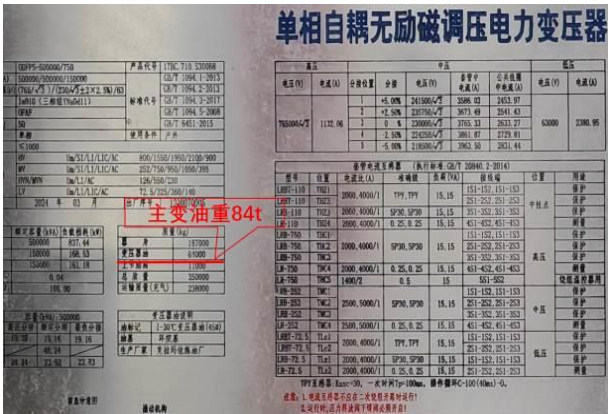
已建主变压器设备铭牌
