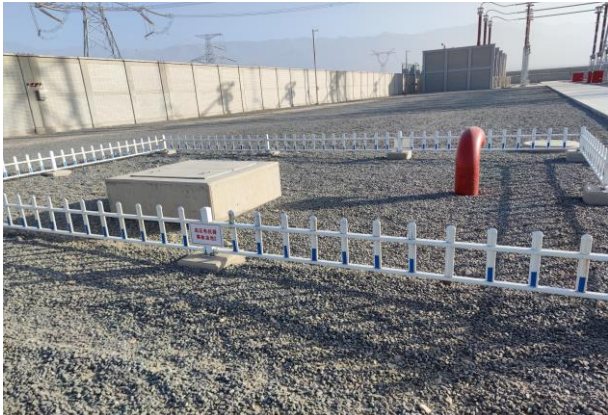
且末~若羌I回、若羌~羚羊I、II回高抗事故油池
