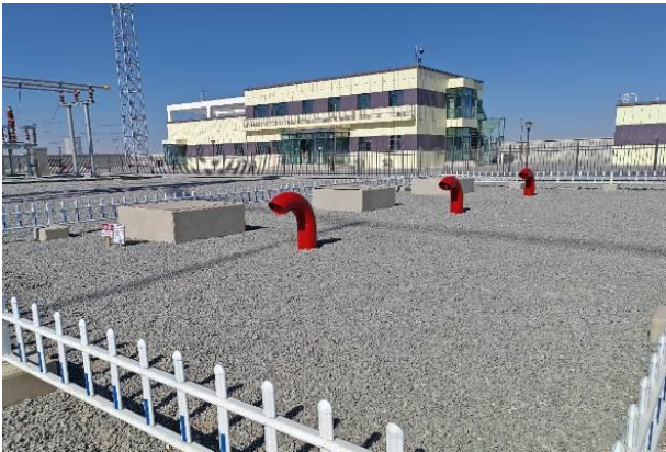
主变事故油池
