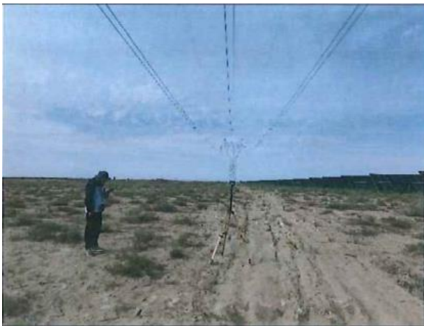
220kV 阜东寒一线监测现场照片
