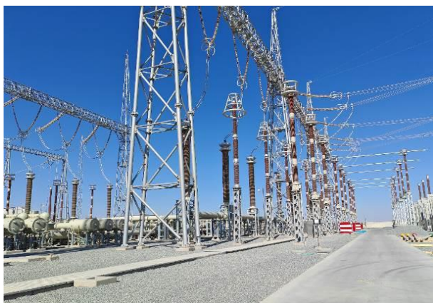
750kV 配电装置区
