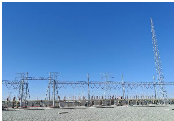
220kV 配电装置区
