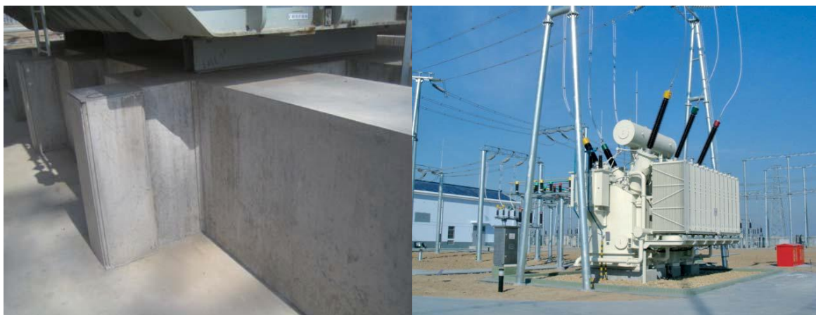
主变储油池示意照（围堰大于设备轮廓 1m）主变基础示意照（储油坑上铺设卵石层）
