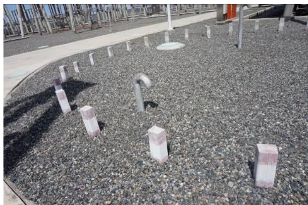
图 3-1 崇光变事故油池
