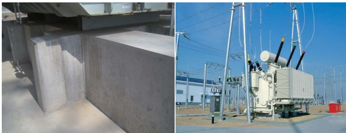
主变储油坑示意照（围堰大于设备轮廓 1m）主变基础示意照（储油坑上铺设卵石层）
