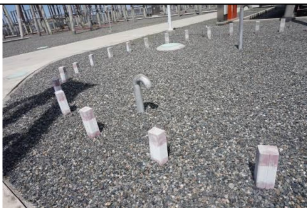
图 2-2 崇光变事故油池
