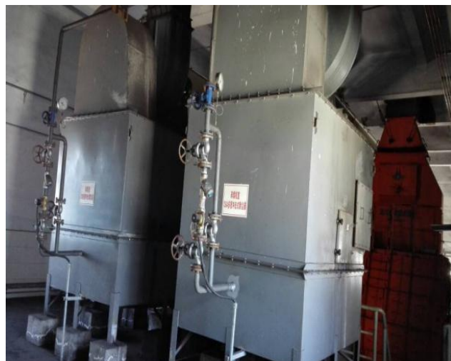
输煤装运站除尘器
