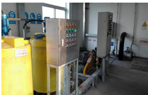
生活污水处理设施
