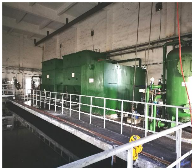
含煤废水处理设施
