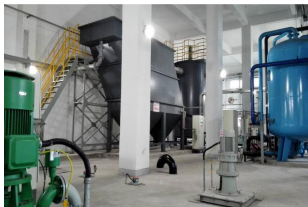
工业污水处理站
