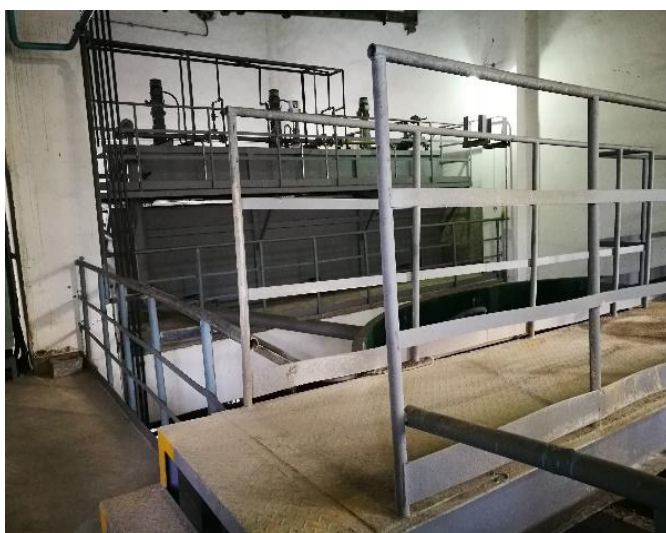
脱硫废水处理设施
