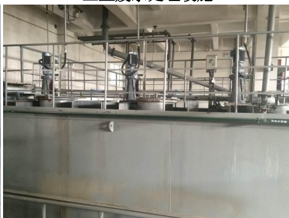
脱硫废水处理设施
