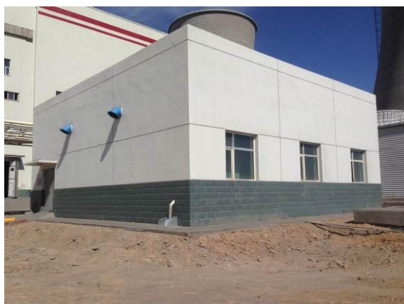
生活污水处理系统
