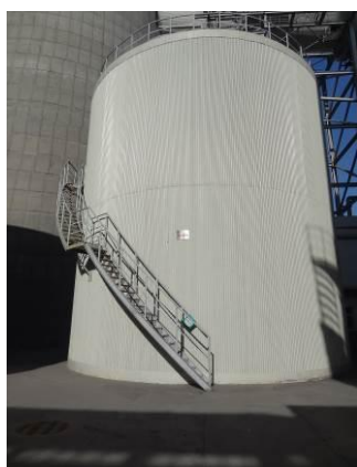
脱硫塔事故浆液箱
