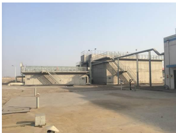
工业废水处理设施
