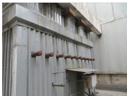
静电除尘器监测点位
