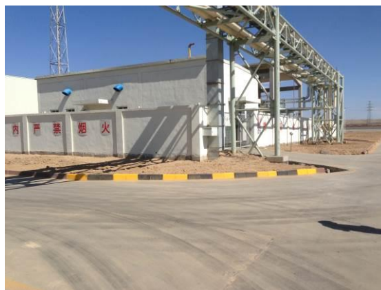
氨罐区防护设施
