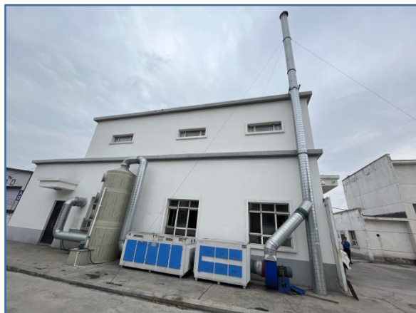
高温蒸汽灭菌废气处理设施
