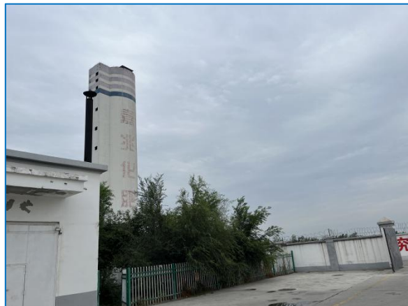
燃气锅炉烟囱
