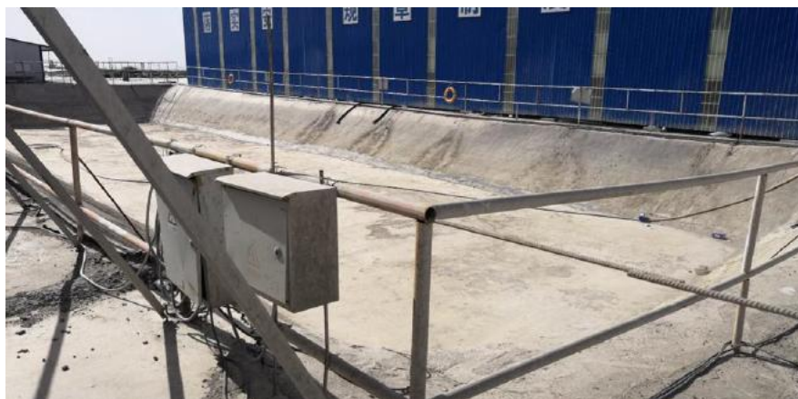
图 6.3.1-1 综合营地施工废水沉淀池
