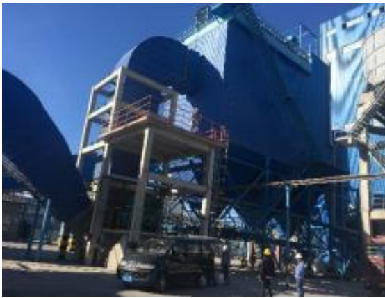
锅炉电袋复合除尘器
