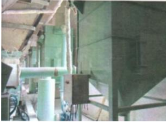
包装车间布袋除尘器
