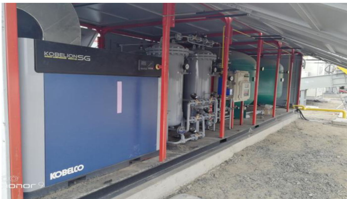
图 3.3-8 制氮设备装置
