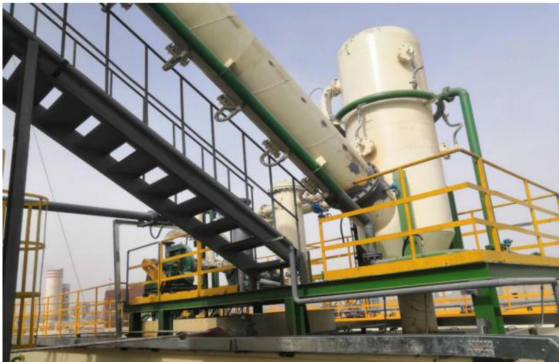
图 3.3-3 热脱附气处理设备装置
