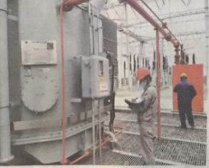
近日，吐鲁番供电公司工作人员正在对变电站设备进行调试。
