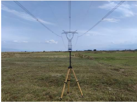
750kV 伊库 I 回监测现场照片
