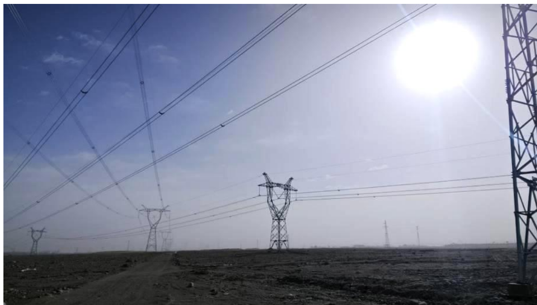
图 3.1-7 跨越尼雅-民丰 220kV I、II 线
