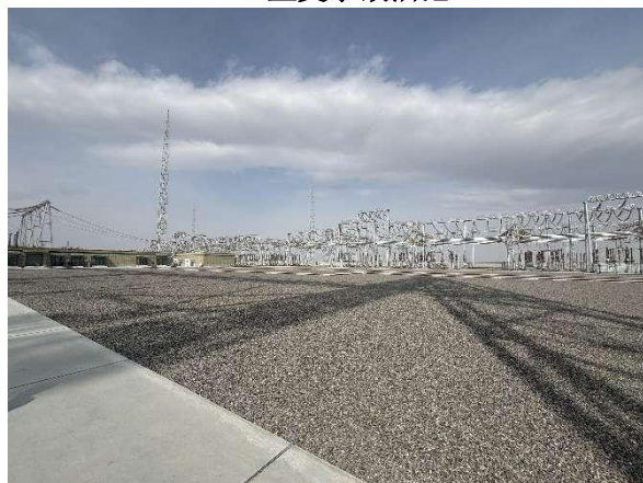
本期主变扩建位置
