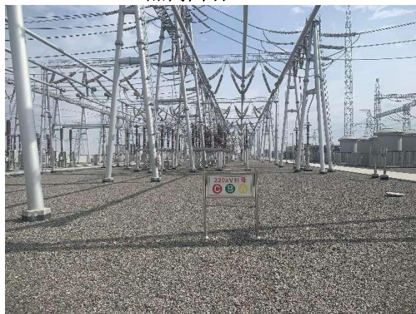
220kV 配电装置
